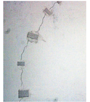
Algunas grietas han sido resanadas en el pasillo de la planta principal.
