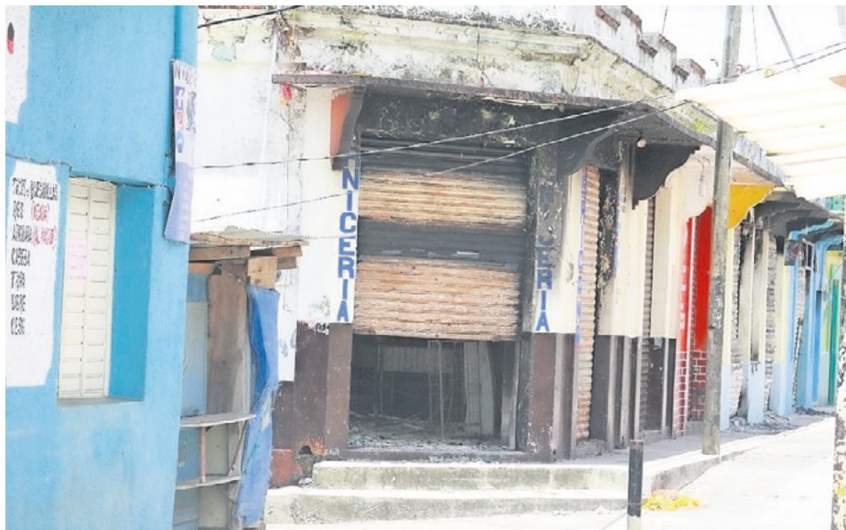
Unas 17 casas y comercios fueron destruidos por hombres armados, que también saquearon decenas de viviendas, entre ellas la de María y su hija.
